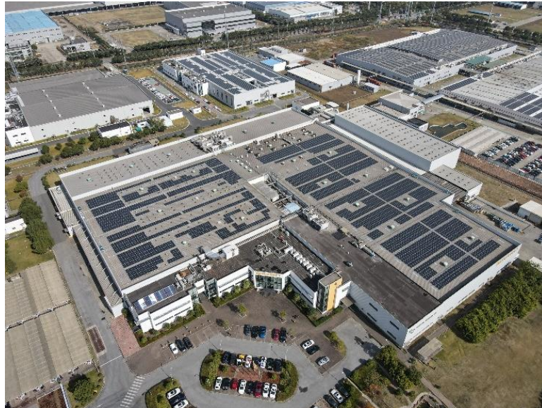
大陆汽车系统常熟有限公司 2.12 MW 分布式光伏电站全景 Full view of Solar Power Plant
